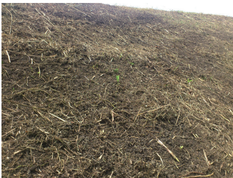
写真 62 かなり激しく除草された法面
